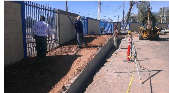
TERRAPLEN DE ACCESO A CD. DEPORTIVA
